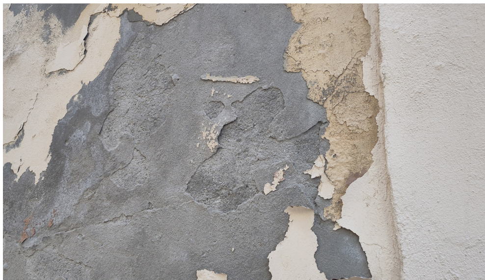
▲ Exemple de symptôme d'humidité dans les parois, photo : Samuel Courgey
